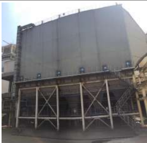
#6 机组六室五电场静电除尘器
